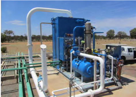
Alice Spring LNG Plant
