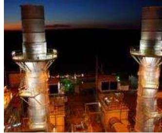
Bypass & HRSG Exhaust System
