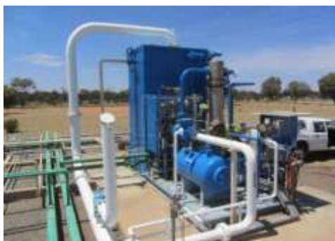
Alice Spring LNG Plant
