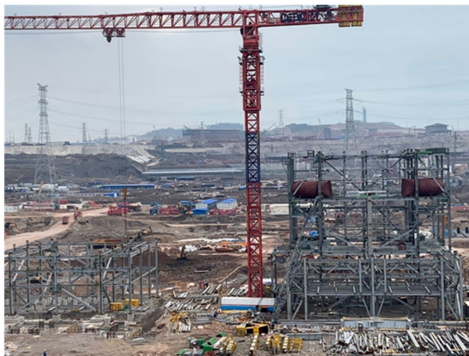
ONI Power Plant
